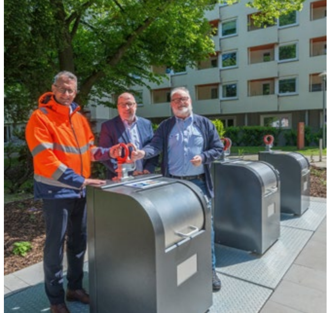
EBE-Geschäftsführer Karsten Woidtke, Allbau-Geschäftsführer Dirk Miklikowski und Bezirksbürgermeister Peter Valerius (v. l.) nehmen die neuen Unterflur-Container in der Hölderlinstraße in Betrieb.
